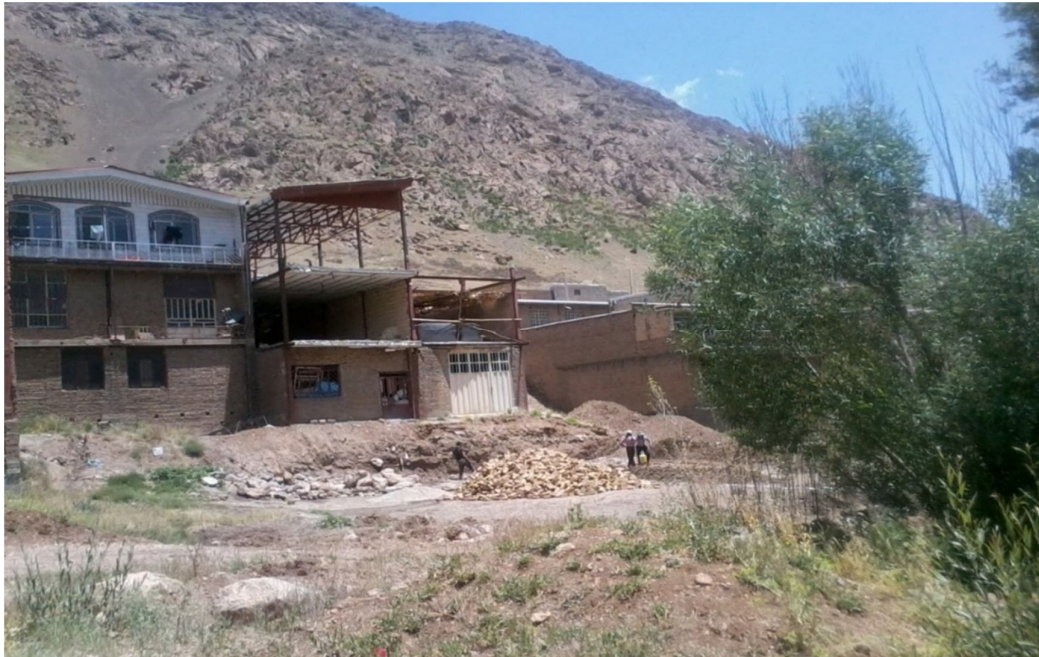
شکل شماره 2- تصویر ساخت مسکن در روستای ونایی، مصالح با ویژگی های محیطی اکولوژیک همخوانی ندارد و تحت تأثیر الگوهای شهری و مصالح نوین ساخته می شود.
