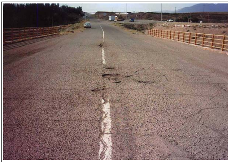
شکل (۱-۸) ترک‌های حاصل از عمل یخبندان آبهای زیر ساخت جاده و تخریب آن
