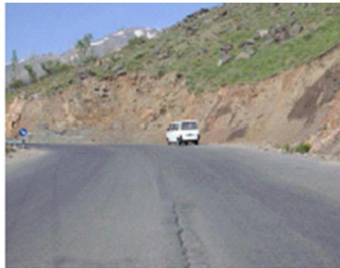
عکس ۹- بریدگی شیب در اثر جاده سازی
