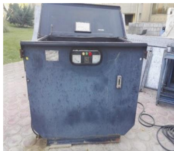
Fig. 3. A rectifier transformer.
