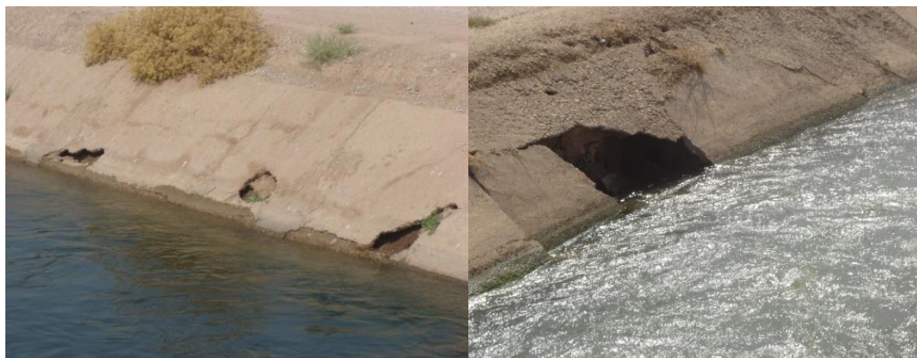
شکل ۳- شکستگی بدنه بتن کانال E4 و تلفات آب در مسیر
