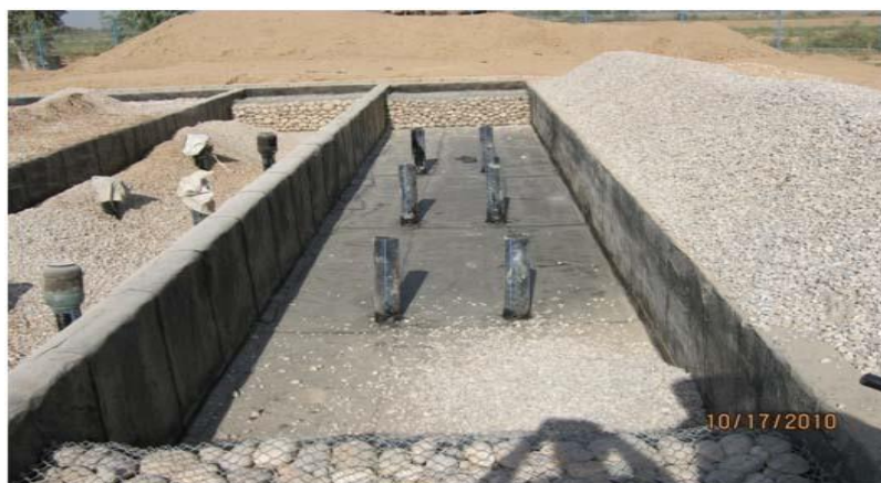
شکل ۳- سازه ورودی و خروجی وتلند زیرسطحی سردارآباد شوشتر
