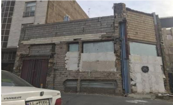
تصویر ۸- وجود ساختمان‌های رها شده و نا ایمن در سطح محله
