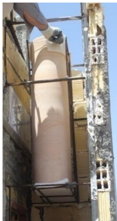
شکل ۲- چهار استوانه رسی نصب شده درون کانال بادگیر
