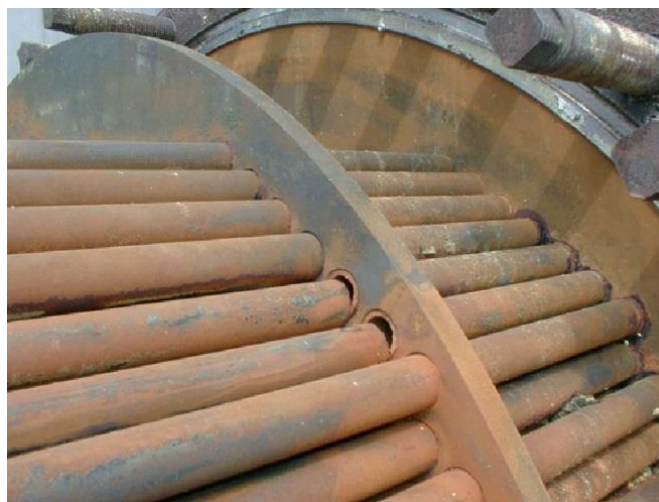
شکل (۲): شکست مکانیکی در ناحیه اتصال لوله‌ها به بافل.
