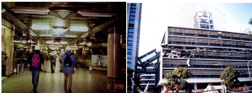
شکل ۵: مقایسه آسیب وارد شده به ساختمان‌های روزمینی و زیرزمینی در زمین‌لرزه ژاپن، کوبه سال ۱۹۹۵ (Godaed, 2004)
