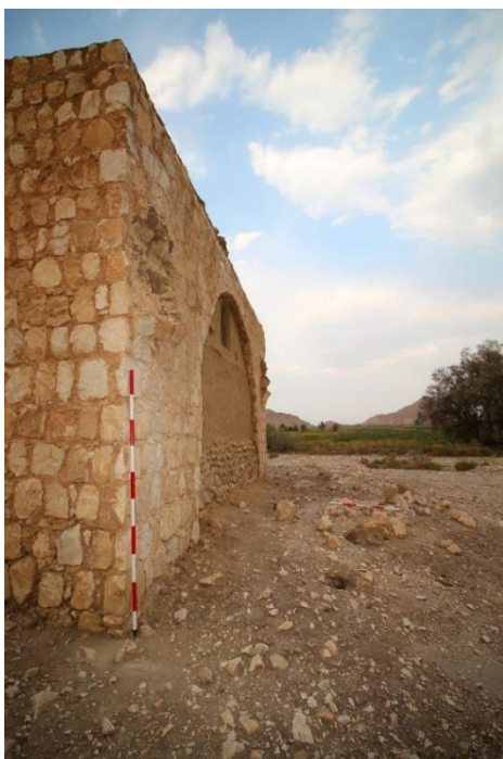
تصویر ۱۱- بقایای داغی‌های قوس راهروی میانی در ضلع جنوب شرقی چهارطاقی رحمت آباد (نگارندگان)
