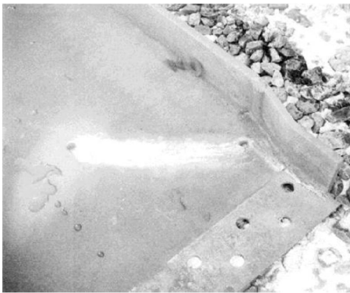
شکل ۳ تعمیر ترک با روش سوراخ متوقف کننده [۱]
