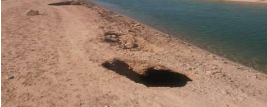
شکل ۴: تخریب ایجاد شده در نقطه ۱ کانال پای پل
