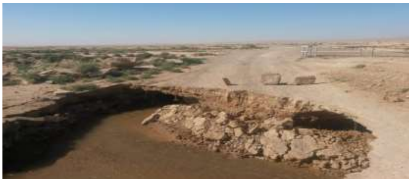
شکل ۵: تخریب ایجاد شده در نقطه ۲ کانال پای پل
