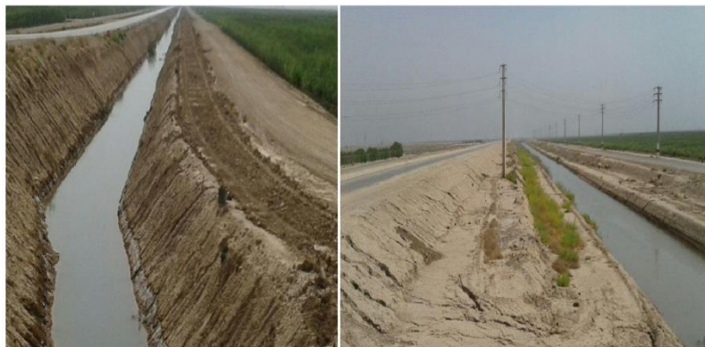
شکل ۱: کانال‌های زهکشی کشت و صنعت دهخدا
