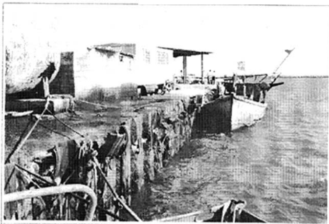
شکل شماره ۱۳: فرسایش اسکله بندر گاههای صیادی حسینیه که پهلوگیری شناورها را شدیداً مشکل ساخته است.
