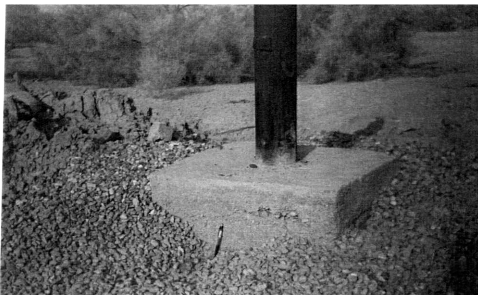
شکل ۴ - بالا زدگی فونداسیون لوله چاه ایستگاه تثبیت ماسه شهید صدوقی
