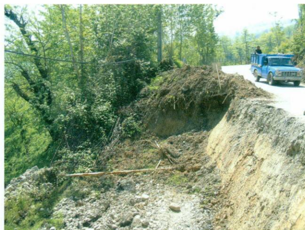
تصویر ۳- عملکرد زمین لغزش در تخریب راه ارتباطی گلوگاه فیروزجا، زیرحوضه‌ی آبریز سجاد رود
