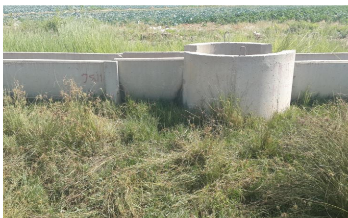
شکل ۱۰- ریزش آب از سازه مقسم ، رشد علف های هرز ، ماندابی و لجنی شدن محل
