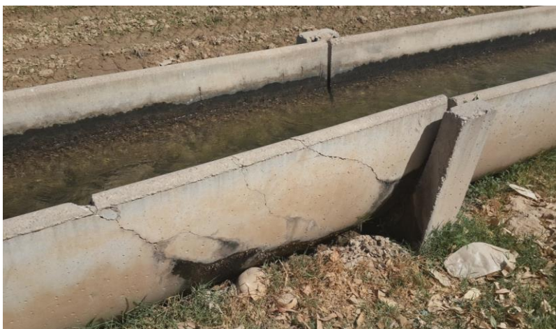
شکل شماره ۴- شکستن کانالت و نشت آب و عدم تعویض آن
