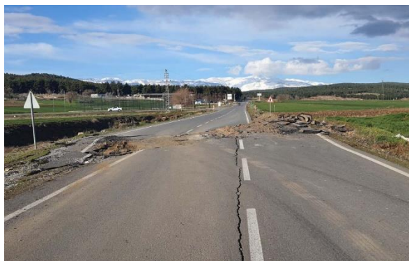
شکل ۷- تصویری از ایجاد شکاف عمیق و جابجایی جاده‌ای در زلزله ۲۰۲۳ جنوب ترکیه [۱۱].
