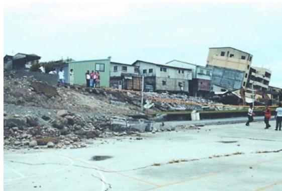
شکل ۲- اسکارپ گسلی و پیامد ساخت و ساز در محدوده‌ی اجتناب از گسل. اسکارپ گسل معکوس در نتیجه زلزله چی-چی در سال ۱۹۹۹ تایوان که ناحیه گسیختگی گسل در قسمت میانی تا قسمت پایین اسکارپ اتفاق افتاده است. به کج شدن و تخریب ساختمان‌های موجود در بلوک بالادست (فرا دیواره) گسل توجه شود [۳].
