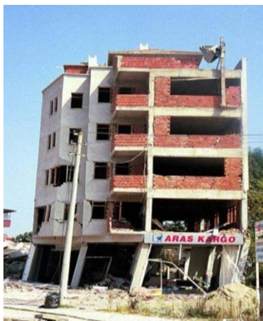
شکل ۲- ایجاد طبقه نرم در اثر حذف دیوارهای آجری طبقه همکف در زلزله ۱۹۹۹ کواکلی ترکیه [۱۱]
