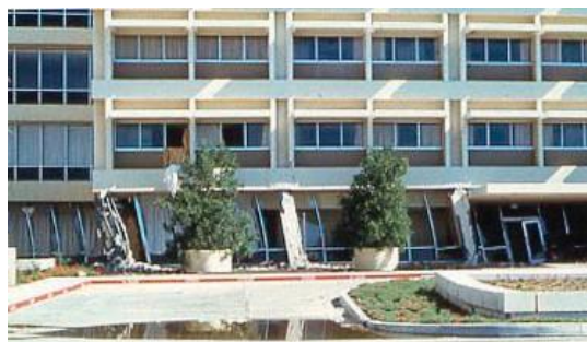
شکل ۱- ایجاد طبقه نرم در بیمارستان الیویو در زلزله ۱۹۷۱ سان فرناندو در اثر حذف دیوارهای برشی طبقه همکف [۷]
