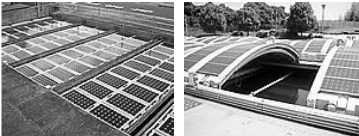
شکل ۳- صفحات خورشیدی نصب شده در قسمت‌های مختلف تصفیه‌خانه کاوایی (حوضچه‌های ته‌نشینی و توزیع آب)
