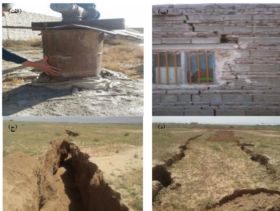
شکل ۶. نمونه‌ای از لوله‌زایی ایجادشده در روستای کلاته برفی (الف)؛ ایجاد ترک در ساختمان‌های مسکونی در منطقه توس مشهد (ب)؛ شکاف یا شق به وجود آمده ناشی از پدیده فرونشست در منطقه کلاته برفی دشت مشهد (ج و د) (۹۷/۱۲/۸)
