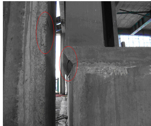
ج: وجود فرسودگی و عدم پوشش کافی پایه ستون دیده می‌شود.
