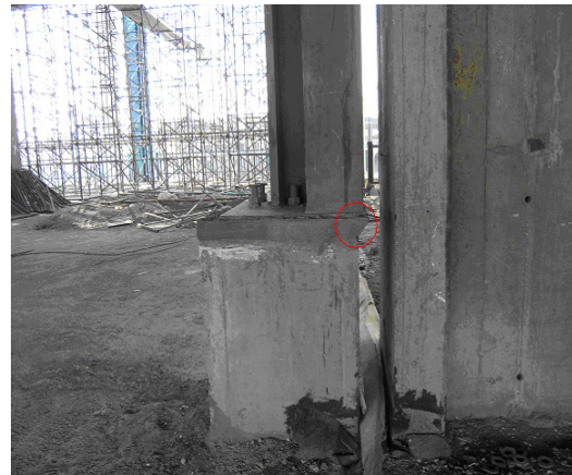
الف: وجود فرسودگی، شکستگی و عدم پوشش کافی پایه ستون‌ها دیده می‌شود.
