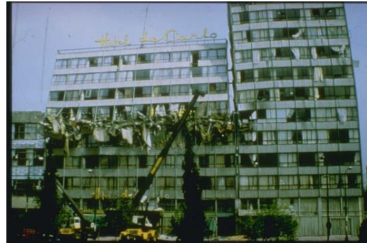
شکل ۲. تخریب دو ساختمان مجاور تحت ضربه در زلزله مکزیکوسیتی [۹]
