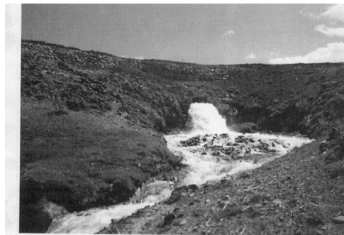
تصویر ۱۲- جریان آب از دیواره شمال غربی سد روسا
