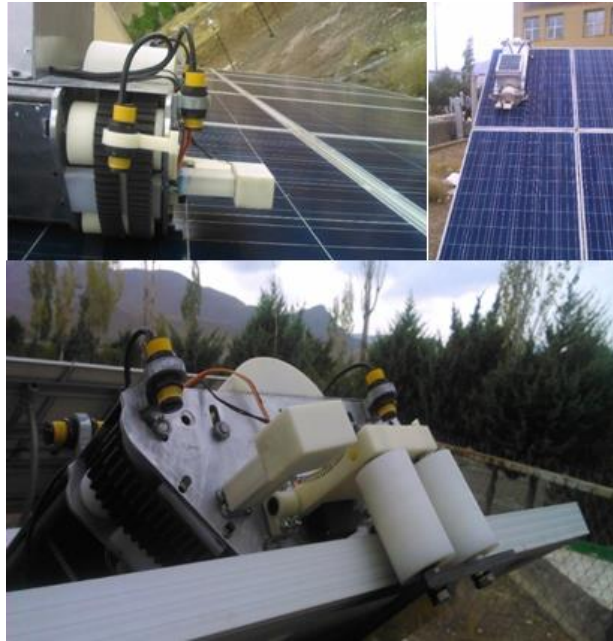
شکل (۲۴): تست ربات با باتری بر روی نیروگاه خورشیدی Figure (24): Test of the robot with the battery on the solar power plant
