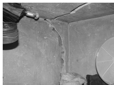
شکل شماره (۵): ناپایداری در مقابل زلزله
