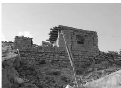
شکل شماره (۶): ناپایداری واحدهای مسکونی
