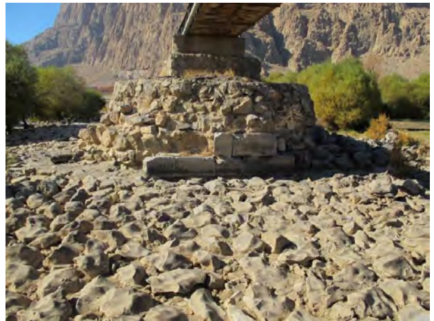
تصویر ۹: نمایی از پایه تخریب شده پل خسرو (عکس از نگارنده).
