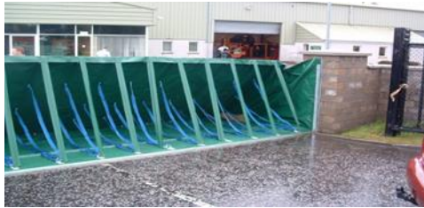
شکل ۱۷- جلوگیری از ورود سیل به محوطه‌های مسکونی و صنعتی
