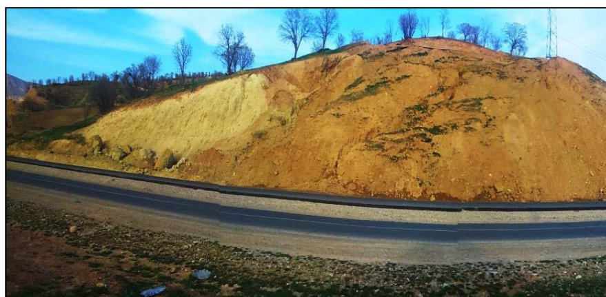
شکل ۱. شکاف‌های ایجاد شده پس از وقوع زمین‌لغزش در نزدیکی روستای رباط دولت‌آباد، دید به غرب، (۱۳۹۵/۰۱/۰۹)
