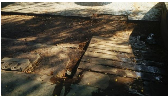
شکل ۴. کفسازی های کنده شده و نامناسب
