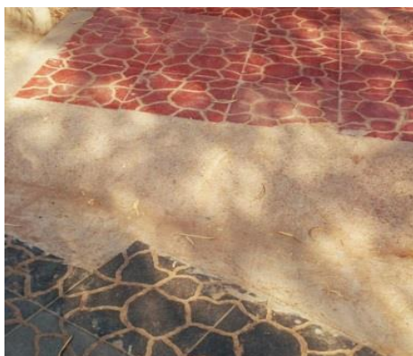
شکل ۳. اتصال نامناسب کفسازی ها
