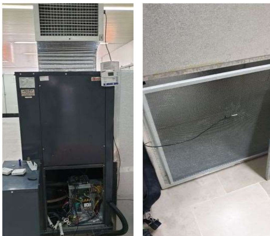
شکل ۲- نصب سنسور جهت دیتابرداری از دستگاه های پمپ حرارتی زمین گرمایی ساختمان پست برق وردآورد
