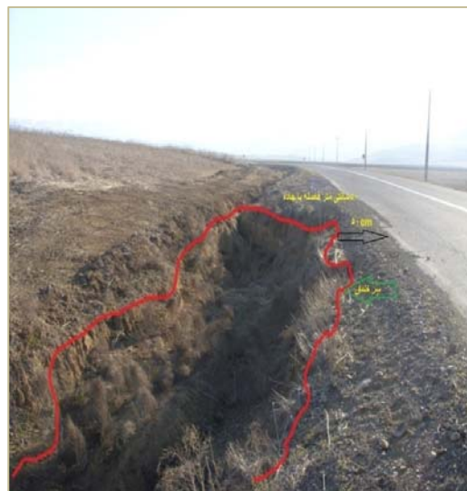
شکل شماره ۱ - تأثیر فرسایش خندقی در تحدید جاده
