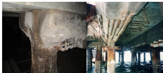
شکل ۱- خوردگی اعضای بتنی یک سازه دریایی
