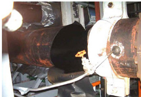
شکل ۸- ترکیدن خط کندانس ۱۲۲ اینچ ناشی از FAC [۲]
