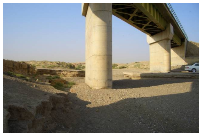
تصویر ۱۰- آب‌شستگی پایه پل‌ها که این خود در اثر برداشت بی‌رویه مصالح از رودخانه می‌باشد - زمستان ۱۳۸۹
