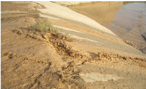
تصویر ۵- تخریب بستر ساخته شده بر رودخانه در اثر سیلاب ناشی از برداشت بی‌رویه مصالح رودخانه‌ای
