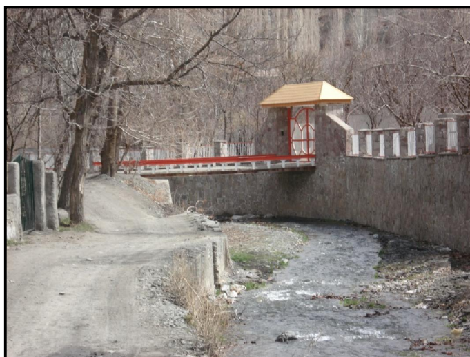
شکل شماره ۲: کاهش عرض بستر رودخانه در نتیجه تغییر غیراصولی کاربری در حریم بستر (مأخذ: نگارندگان، ۱۳۹۲)
