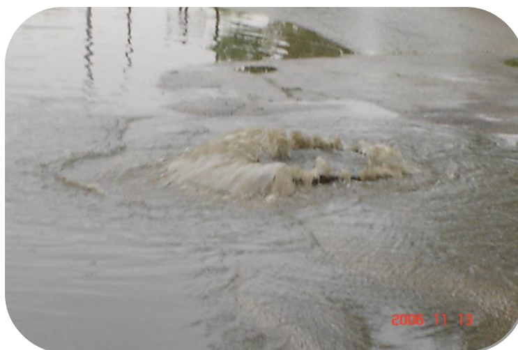
شکل ۱: آبرفتگی معابر بر اثر عدم کارکرد مناسب شبکه جمع آوری فاضلاب
