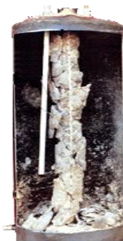
شکل ۳ - یک آبگرمکن در اثر استفاده از آب معمولی
