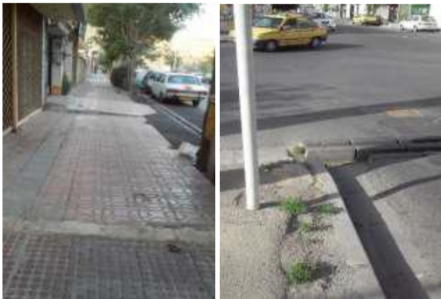
شکل ۳: عدم استفاده از کف پوشهای مناسب - اتصال نادرست پیاده رو به سواره رو
