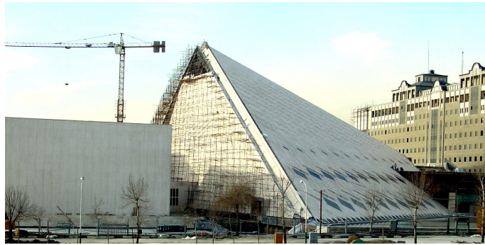
شکل ۵. استفاده از فرم خالص هرم در طراحی ساختمان مجلس شورای اسلامی (ماخذ: ستاوبین، ۱۳۹۵). طراح پروژه در توصیف طرح بیان می‌دارد: «یکی از عوامل مؤثر در شکل‌گیری بنای مجلس، تناسب و ارتفاع و عملکرد دو بنای شمالی و جنوبی بوده است تا این بنا بتواند ضمن استفاده مداوم از دو بنای موجود با محیط اطراف خود نیز هماهنگی کامل را برقرار کند.» (ماخذ: ذکابی، ۱۳۷۸، ۲۹)
