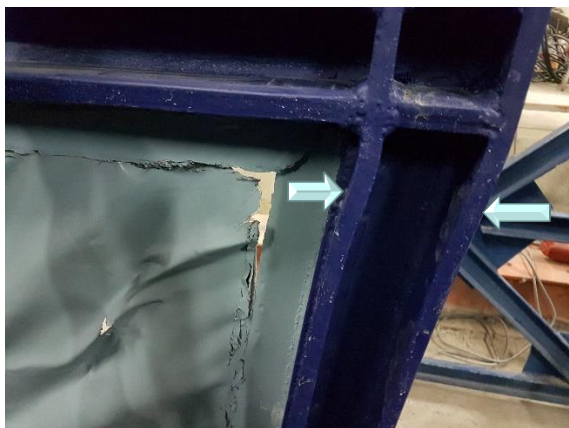
شکل ۲۵ - ایجاد کماتش در محل اتصال تیر به ستون
