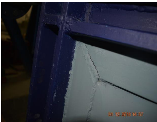
شکل ۱۵- ایجاد اولین ترک در محل اتصال نبشی‌ها
