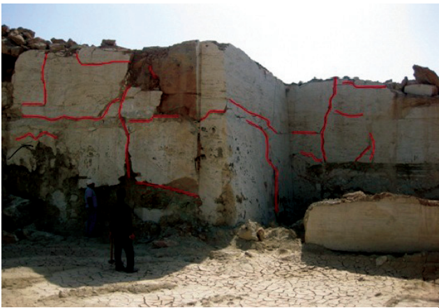
تصویر ۳- تراکم درزه‌ها و شکستگی‌ها در سینه کار شماره یک محدوده تراورتن تزرچ
