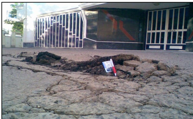
شکل ۲. زیر ساخت نادرست موجب نشست، ترک خوردگی و پیدایش چاله در آسفالت خیابانهای شهر اردبیل می‌شود. این پدیده در شهر اردبیل بسیار بارز و چشمگیر است.
